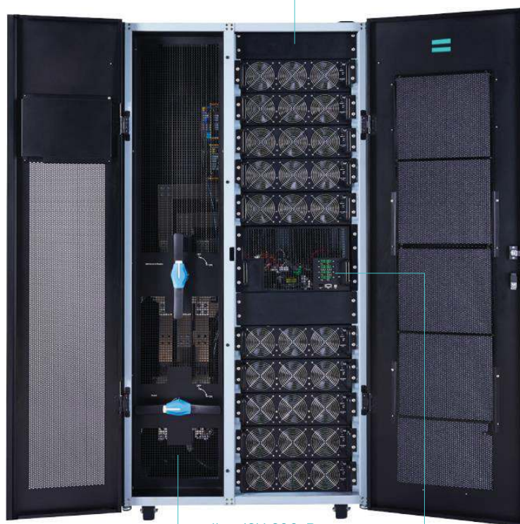
стойка 42U 600кВт
