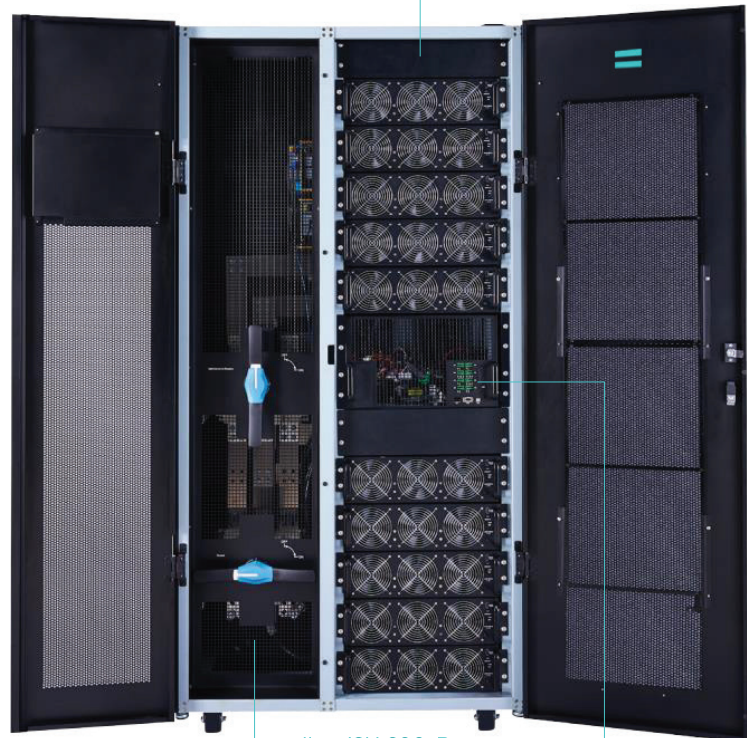
стойка 42U 600кВт
