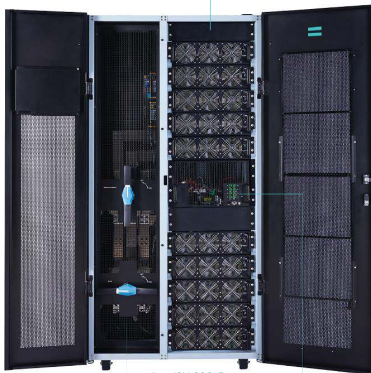
стойка 42U 600кВт
